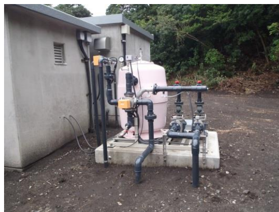
新設された急速濾過装置
