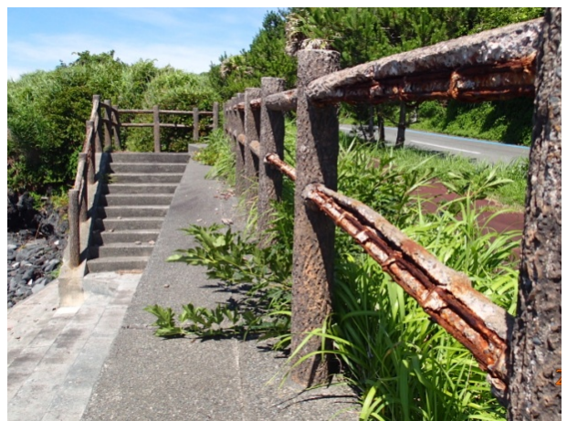
塩害による腐食（万立浜）
