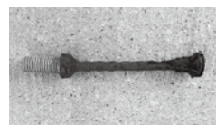
↑錆が進行した足場ボルト
