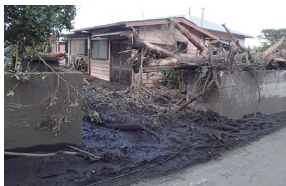
被害を受けた家屋（10 月 16 日）（大島社会福祉協議会提供）
