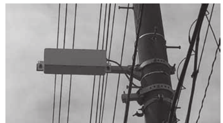
↑電柱に設置した集約装置
