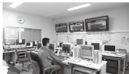
↑制御盤の監視・制御風景
