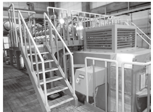
↑大島内燃力発電所 3号機関(4000kw)
