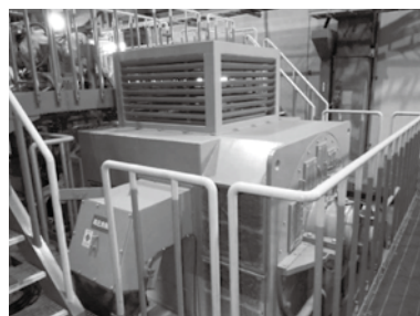
↑大島内燃力発電所 3号機関発電機(4000kW)
