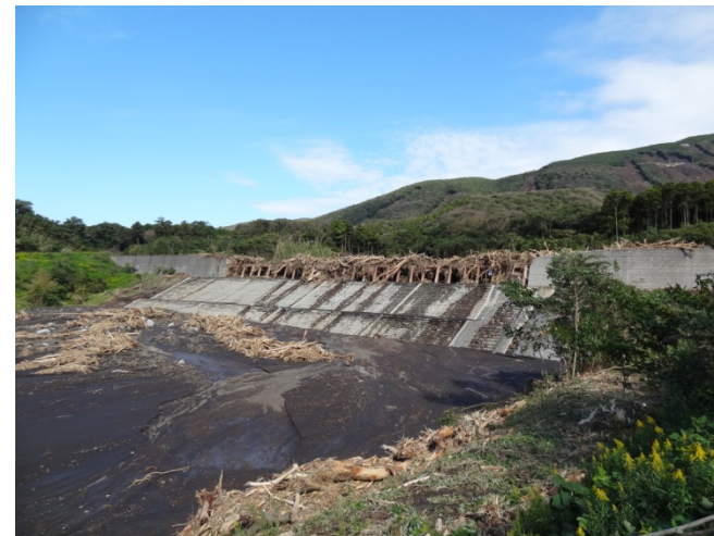
鋼製部に多量の流木が捕捉されている
