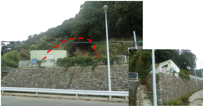
建物裏の斜面が崩壊し、被災している状況
