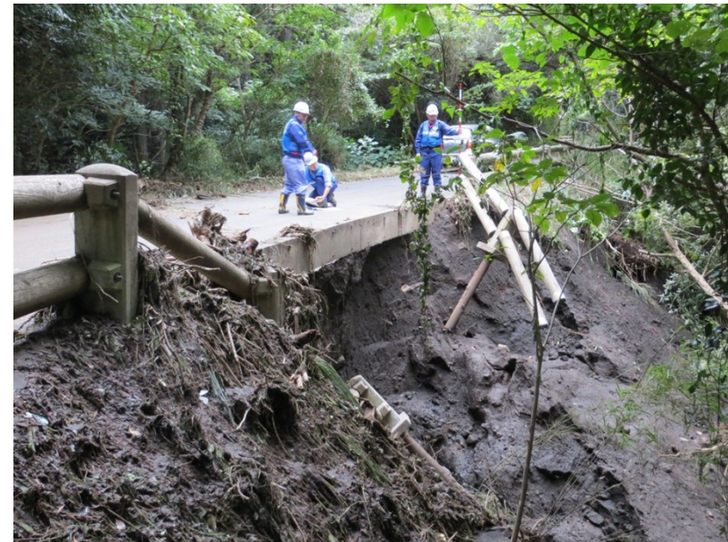
道路下の崩落状況
