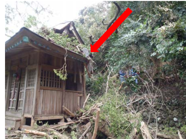
山腹崩壊による神社の被災状況
