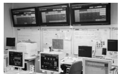
大島発電所の制御室
