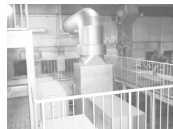
非常用発電機
