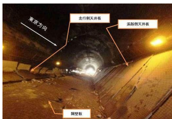
〔写真 笹子トンネル天井板の落下状況〕 (国土交通省HP トンネル天井板の落下事故に関する調査・検討委員会より)
