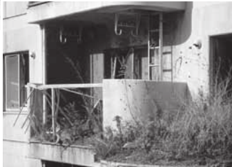
←被災した→住宅
